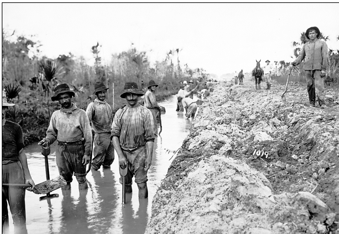
IMAGEM 5. Operários executam obras no leito de drenagem para a ferrovia. (1909-1910). Foto nº 1019 de Dana Merrill. Fonte: Acervo do Museu Paulista da USP
